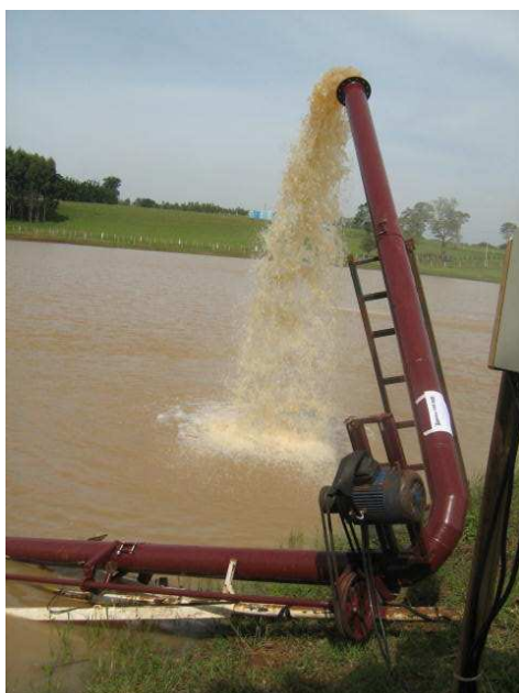
Toma de agua con bomba sumergida
